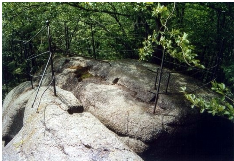
Vrcholová plošina s nefunkčním zábradlím
